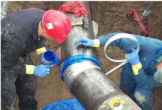
Se remueve la capa protectora de la almohadilla para luego colocar la manga sobre la misma, según procedimiento de instalación.
