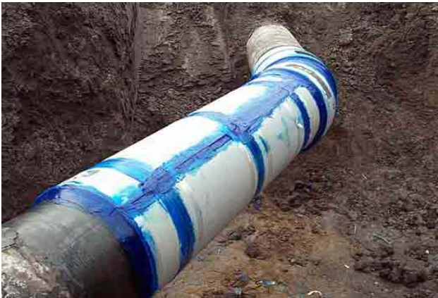
Esta foto demuestra varias mangas, una al lado de la otra, utilizadas para reforzar una amplia zona de corrosión.
